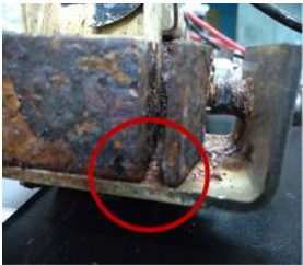
图 A3 铁芯间隙劣化情况 Fig.A3 Deterioration of core gap
